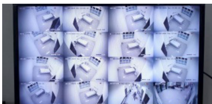
Layar Monitor Central CCTV Ruang Isolasi Mawar
